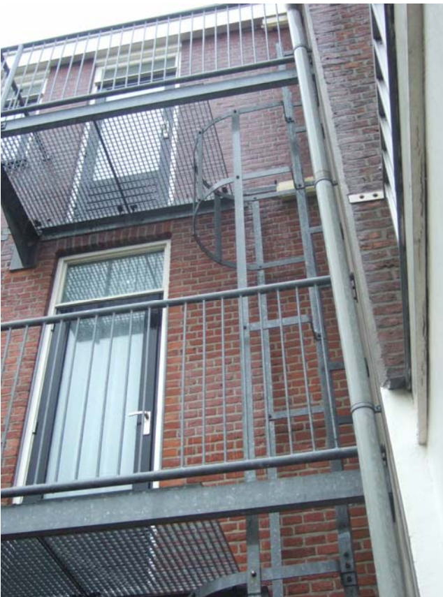
Kooiladders zijn niet toegestaan in vluchtroutes
