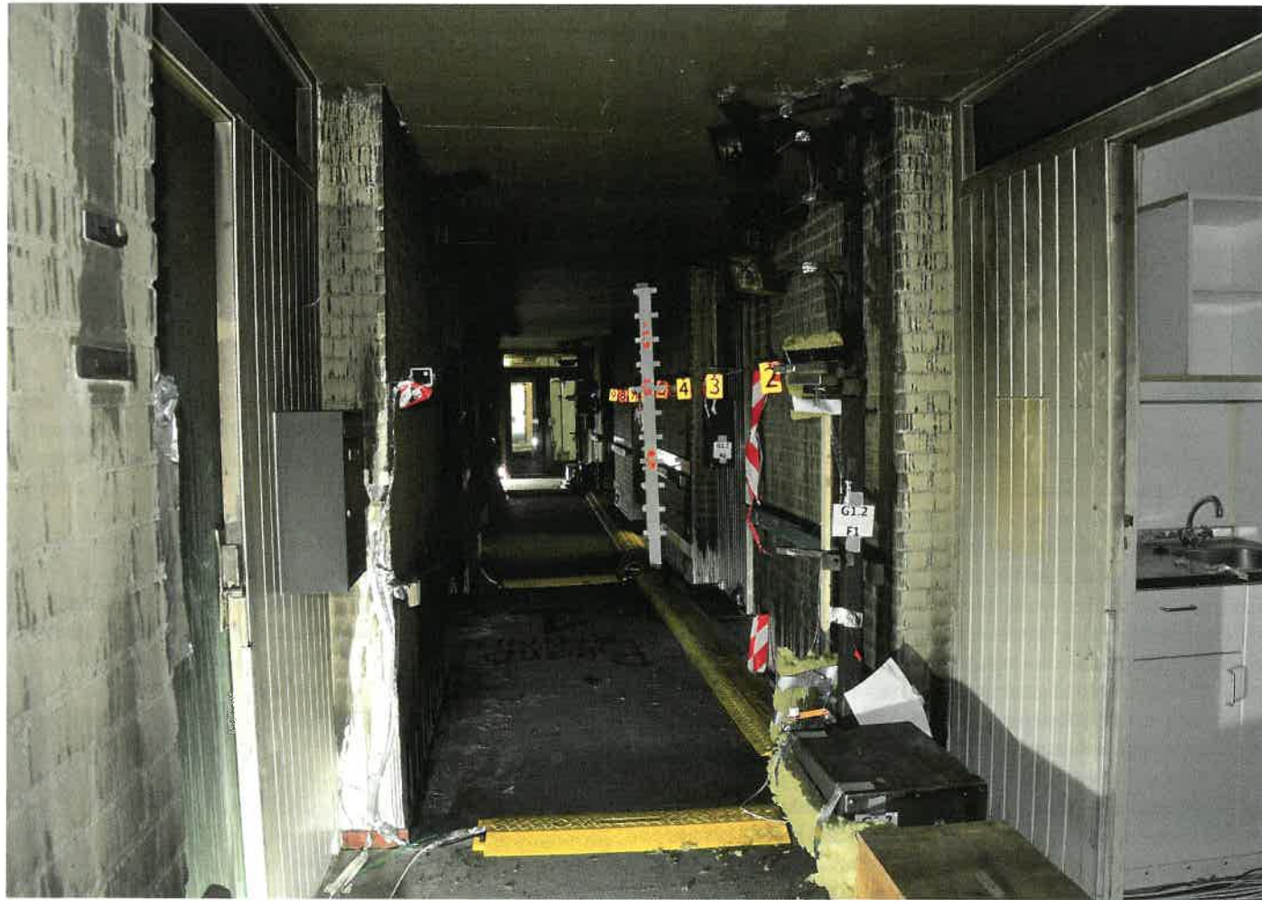
De vluchtweg hangt vol met sensoren om zowel de temperatuuroopbouw, als de vrijkomende stoffen en de rookverspreiding goed in kaart te brengen.
