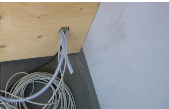
Foto 4: kabeldoorvoer (IFV) vormt luchtlek in 1.20
