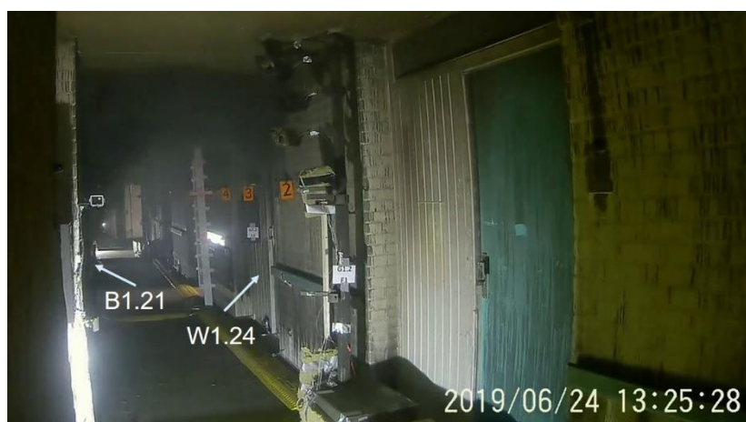
Figuur 1 Camerbeelden na het openen van de deur van de brandruimte, rook 'botst' tegen woning 1.24
